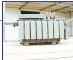
30 MVA 110/11,5 kV ONAN
