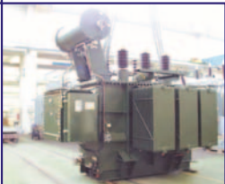
5 MVA 37,5/20,9 kV ONAN
