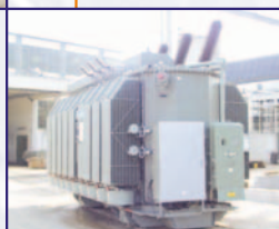
40 MVA 115/21 kV ONAF
