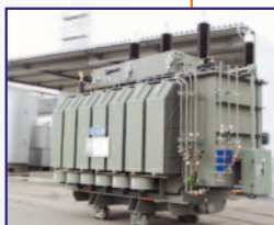
31,5 MVA 120/22 kV ONAF
