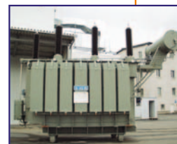
40 MVA 150/10,5 kV ONAN
