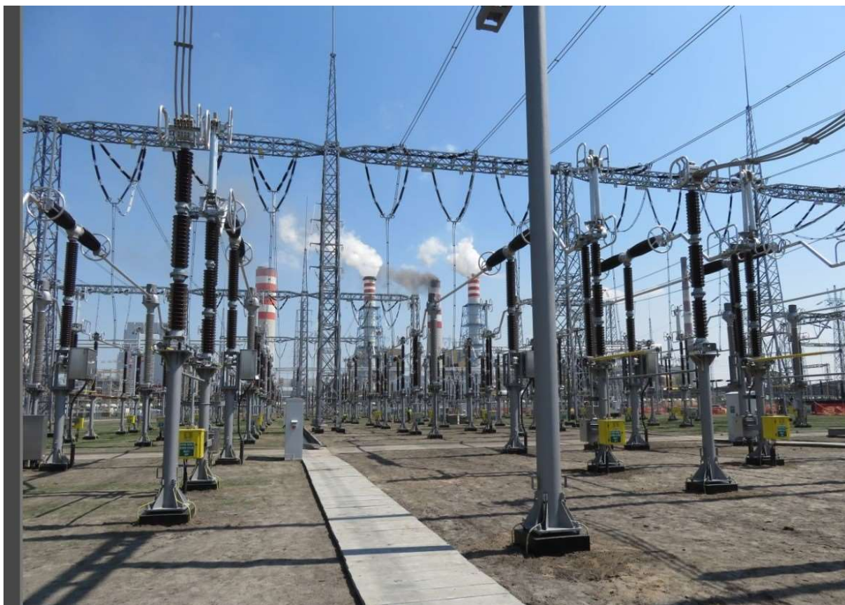
Rysunek 6. Przykład napowietrznej rozdzielni sieciowej 110kV.
